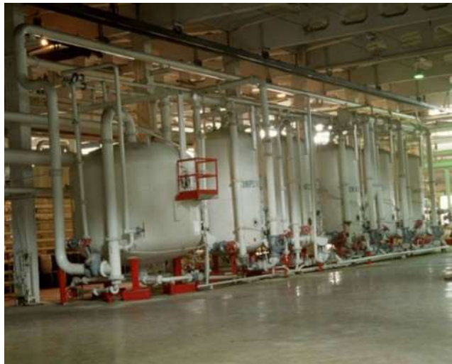
Центральний зал хімоводоочищення
